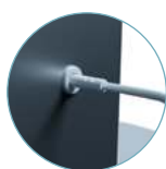
Sistema de entrada de cables
